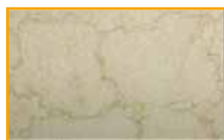
Ejemplo de manchas debidas a impureza en el vapor de condensación
