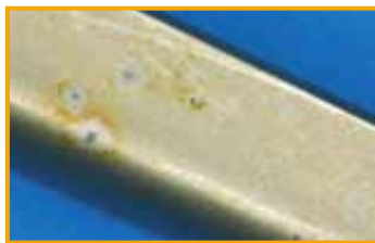
Chloridinduzierte Lochkorrosion auf dem Instrument
